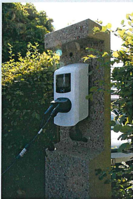
Ladesäule Parkplatz Neuländer
