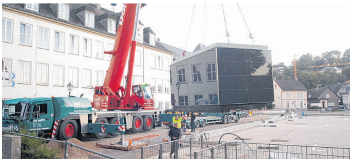
Ein 250-Tonnen Autokran hob das fast 30 Tonnen schwere Toilettenmodul zentimetergenau an seinen Platz am Rand des neuen Parkdecks Feuerteich, das in einer Woche eröffnet wird.
