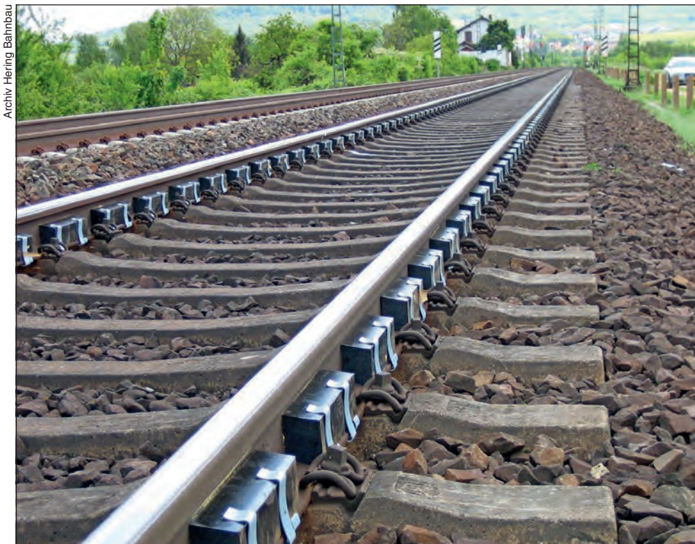
Abb. 1: Einsatz von Schienenstegdämpfern im Rheintal.
